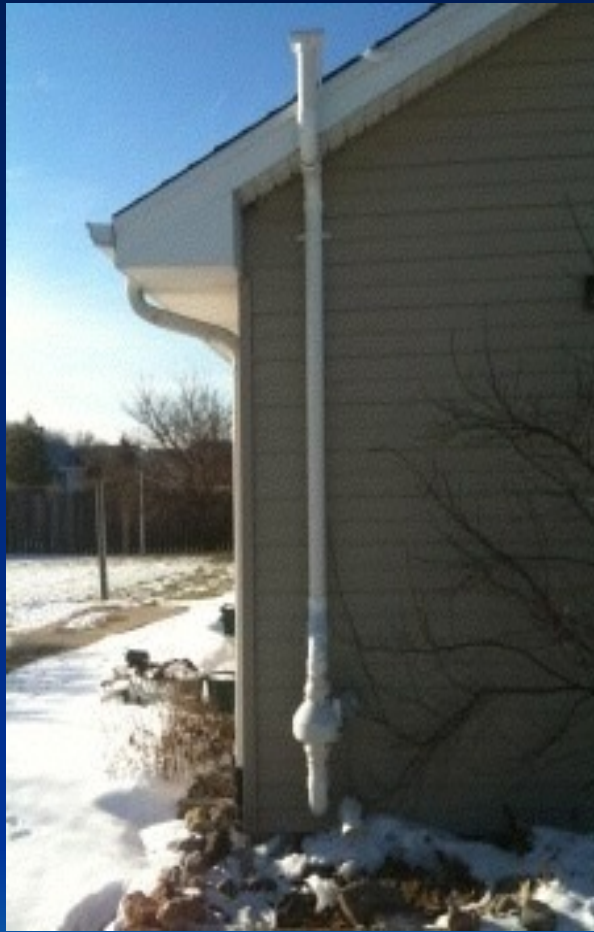
Proper exterior riser pipe
